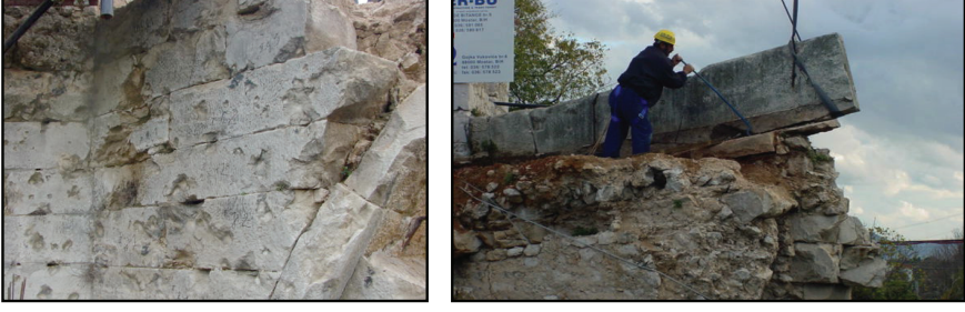
Resim 19, 20: Hasar Gören Orijinal Tempan ve Korkuluk Taşları
